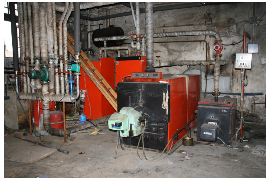
Sala de calderas de gasóleo existente
